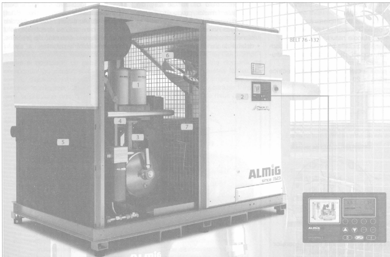
Fig. 8.1.2. Centrală de aer comprimat cu compresoare BELT
